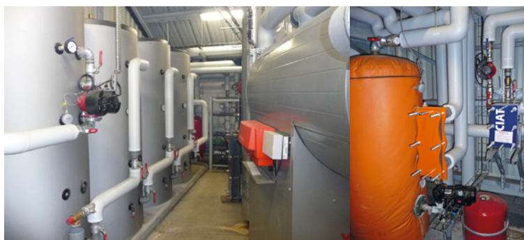
Illustration 8 - Chaufferie au montage complexe ayant entraîné des difficultés lors de la gestion et de la maintenance
