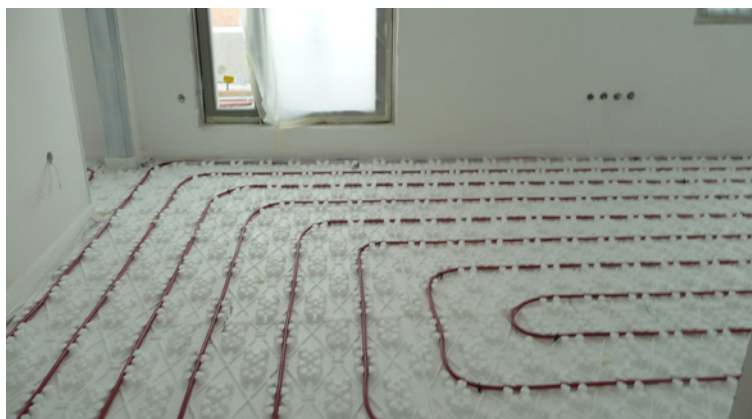
Illustration 13 - Le radiateur à eau standard est l'émetteur le plus souvent installé dans les bâtiments du panel, mais les planchers chauffants répondent au fonctionnement basse température et les radiateurs électriques aux faibles besoins
